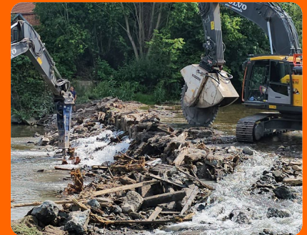
Mit einem zweiten, kleineren Bagger plus Hammer und Löffel wurden die einzelnen Betonsegmente herausgebrochen und ans Flussufer befördert.
